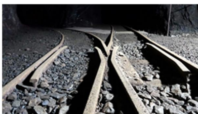
Schienen und Weichen in den Tunnels
